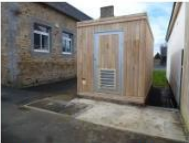
Noeud de raccordement optique (NRO)
